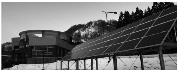
▲ユメリアの駐車場内に設置されたソーラーパネル
