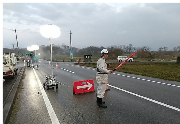
高出力LED設置による注意喚起状況
