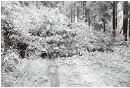
豪雨により法面が崩壊した西仙北地域の 新屋敷1号線
