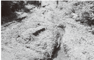
集中豪雨で被災した中仙一般廃棄物最終処分場の管理道路
