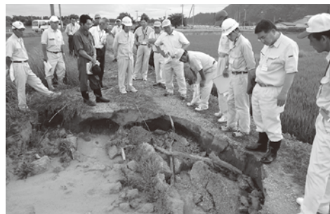
豪雨により決壊した中仙地域の 「市道ウ石持10号線」
