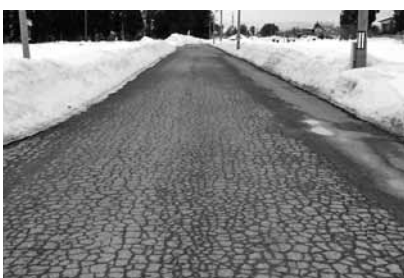
凍上災の被害道路(中仙地域)
