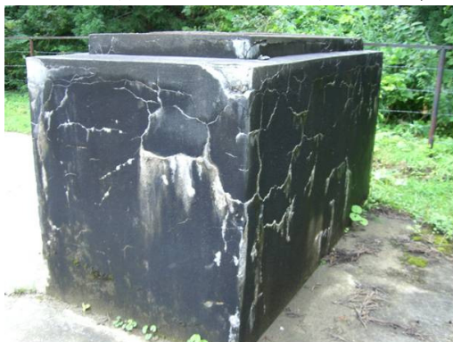
写真 19 宮ヶ沢浄水場（着水井）
