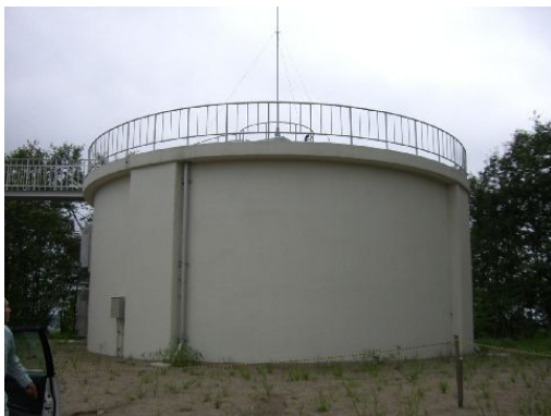
写真 15 刈和野 2 号配水池
