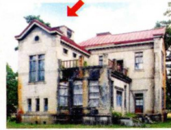
修理前の外観 (矢印が塔屋)
