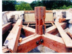
塔屋の屋根を解体した状況 小屋内に当初の合掌が残存していました
