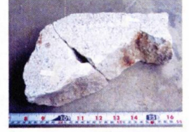
洗い出し仕上げのモルタル片を小屋内から発見
