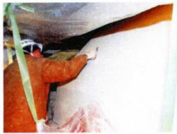
モルタルを塗り付け、 その後水洗いして 洗い出し仕上げ (擬石仕上げ)とします
