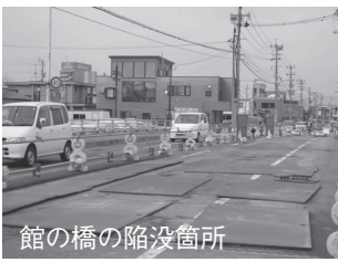
館の橋の交通規制状況
