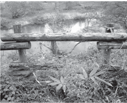
▲八乙女公園の防護柵の破損状況
