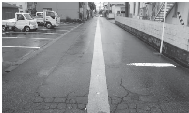
◀新設された消雪施設 (大曲地域朝日町の消雪パイプ)
