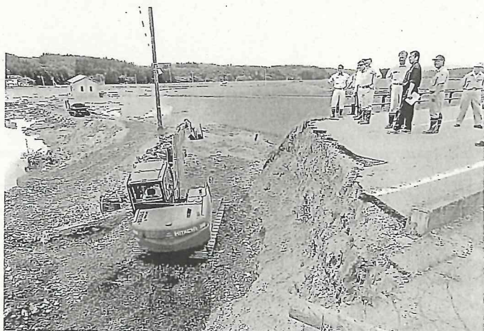
協和中淀川地内 県道決壊箇所
