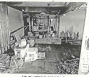
協和下淀川地内 被害状況の視察 床上浸水
