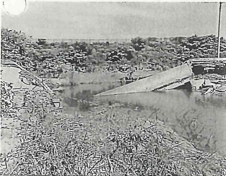
西仙北刈和野地内 市道の落橋
