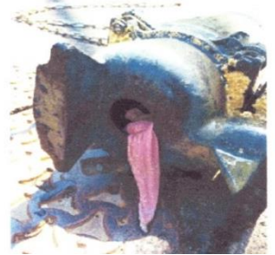
異物が詰まったマンホールポンプ
