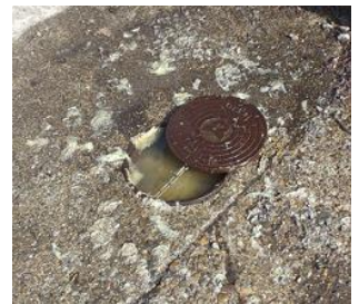
汚水があふれた点検孔
