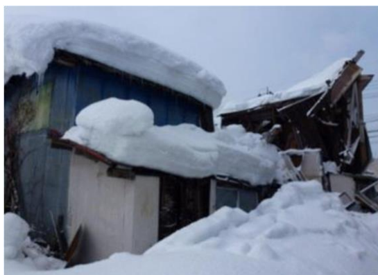
雪の重みで倒壊している空き家
