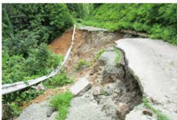
▲豪雨災害発生時には林道被害の速やかな復旧が求められます。
