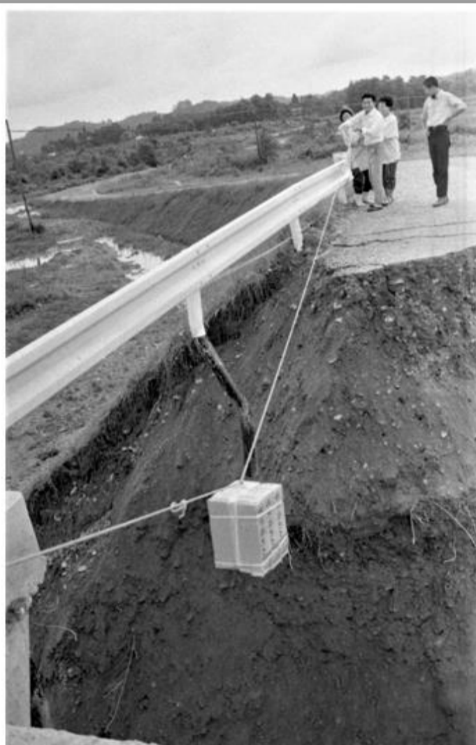
崩れた橋（昭和47年）
