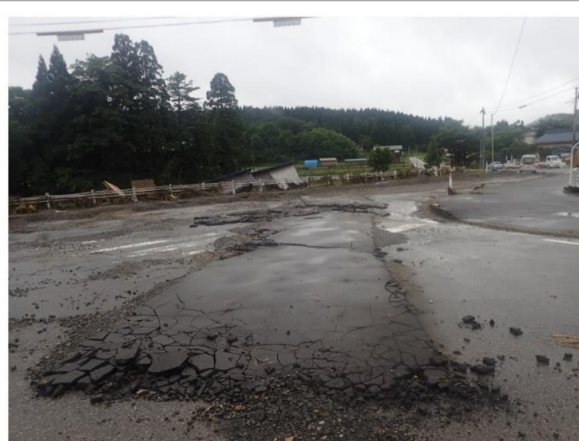
割れたアスファルト（平成 29 年 7 月 23 日撮影）
