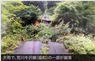
大雨で、荒川牛沢線(協和)の一部が崩落
