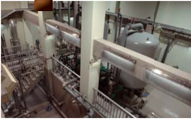
今年から配水を開始した大沢郷地区の簡易水道事業。(写真は大沢郷浄水場の内部)
