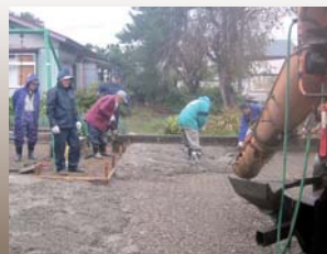
II型 緊急処理事案対応措置事業 (神岡・荒屋児童館前広場舗装)
