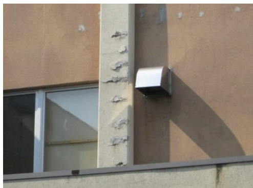
【写真 3】外壁の柱部に鉄筋に沿ってコンクリートの剥離が見られる。落下すると危険なため、早急な処置が必要
