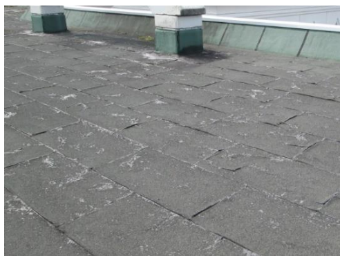
【写真 2】屋上防水シートに表面の摩耗劣化が見られる。
