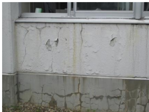
【写真 4】外壁にひび割れや、塗装の剥離が見られる。漏水や、コンクリート強度に影響が出るため早急な処置が必要
