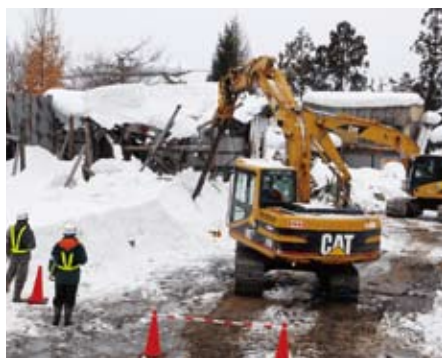
地域住民から解体要望があった空き家には約1.5畝の雪が積もり非常に危険な状態
