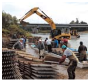
長さ4㍎の塩化ビニール製パイプを板状に組んだ抵抗板
