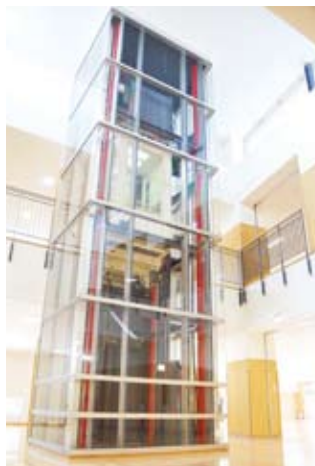
障害がある方へ配慮したエレベーター。
