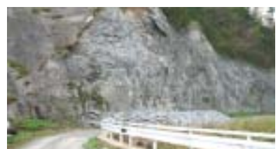
今後も土砂崩れの危険性がある現場。
