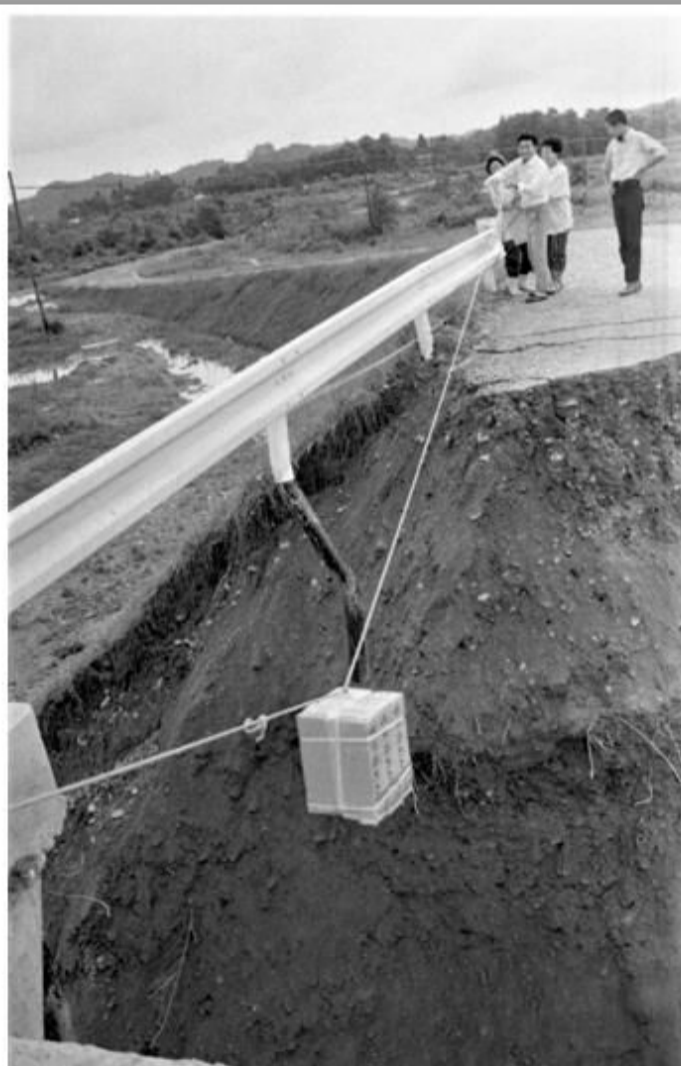
崩れた橋（昭和47年）
