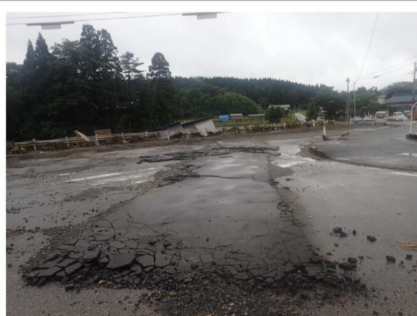
割かれたアスファルト（平成 29 年 7 月 23 日撮影）
