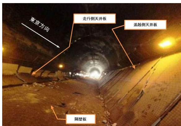
写真-3 天井板崩落状況①
