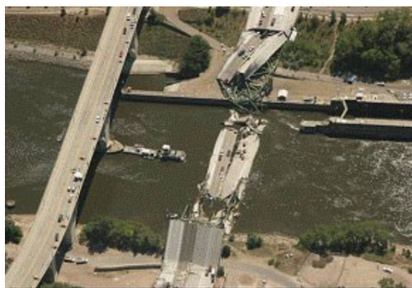
写真-2 I-35W橋の落橋（ミネアポリス橋梁）
