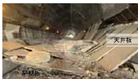
写真-4 天井板崩落状況②
