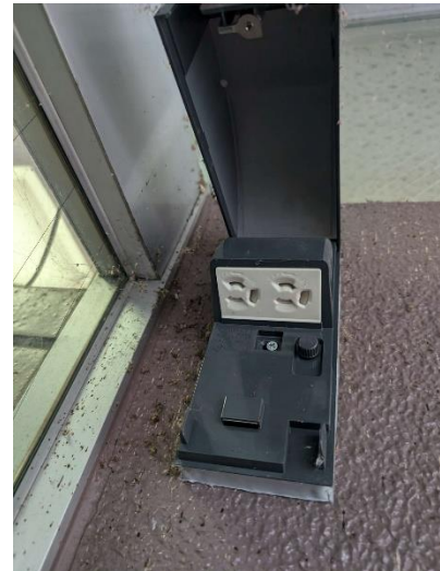
※外付コンセント設置箇所
