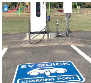
EV 充電器（道の駅協和）
