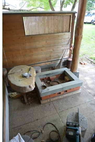
■ 民泊棟バーベキュー設備
